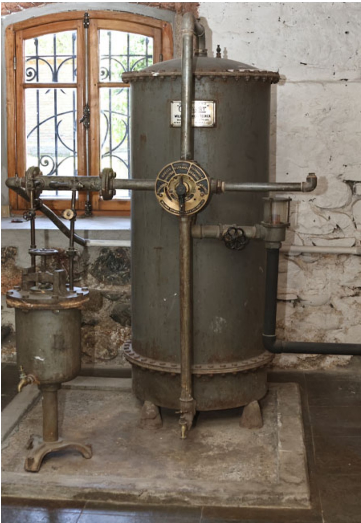
Caldera (componente de sistema de climatización)
