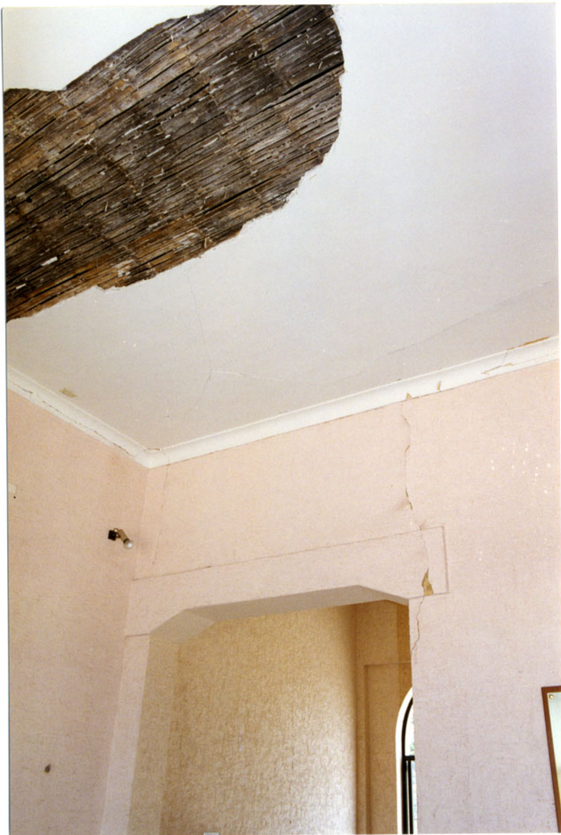
Terremoto en Ovalle
