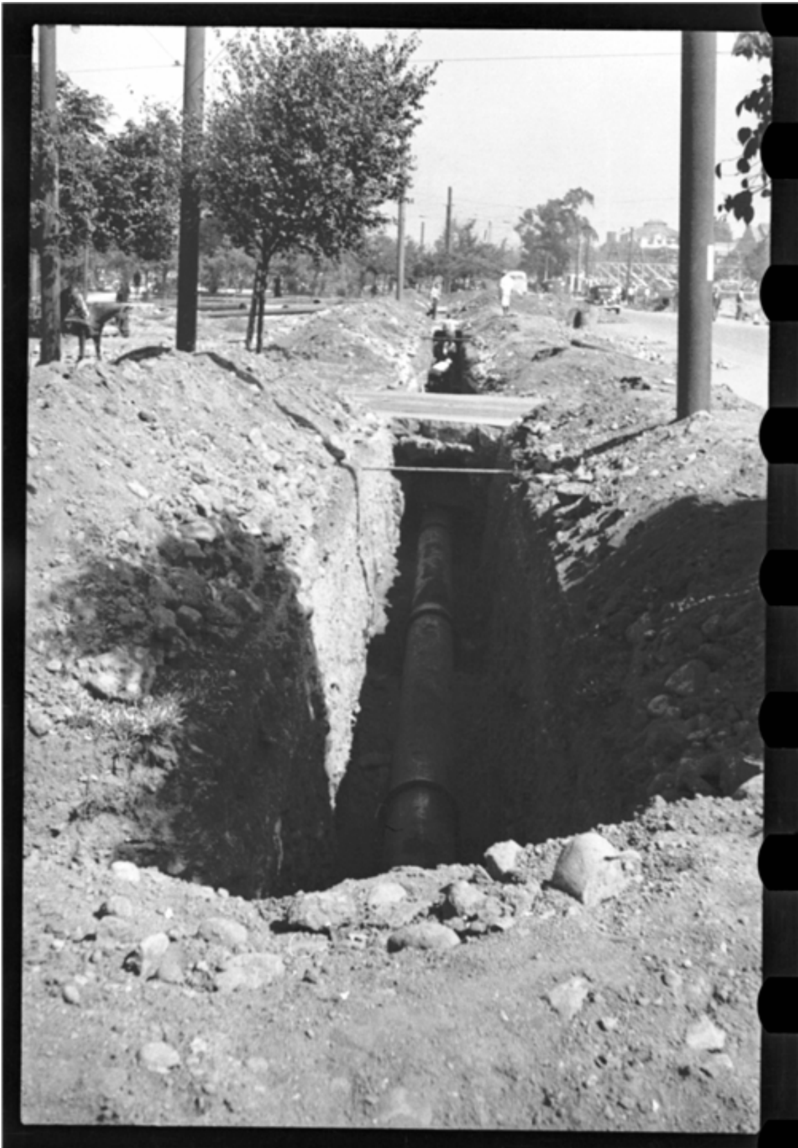
Ductos de agua potable
