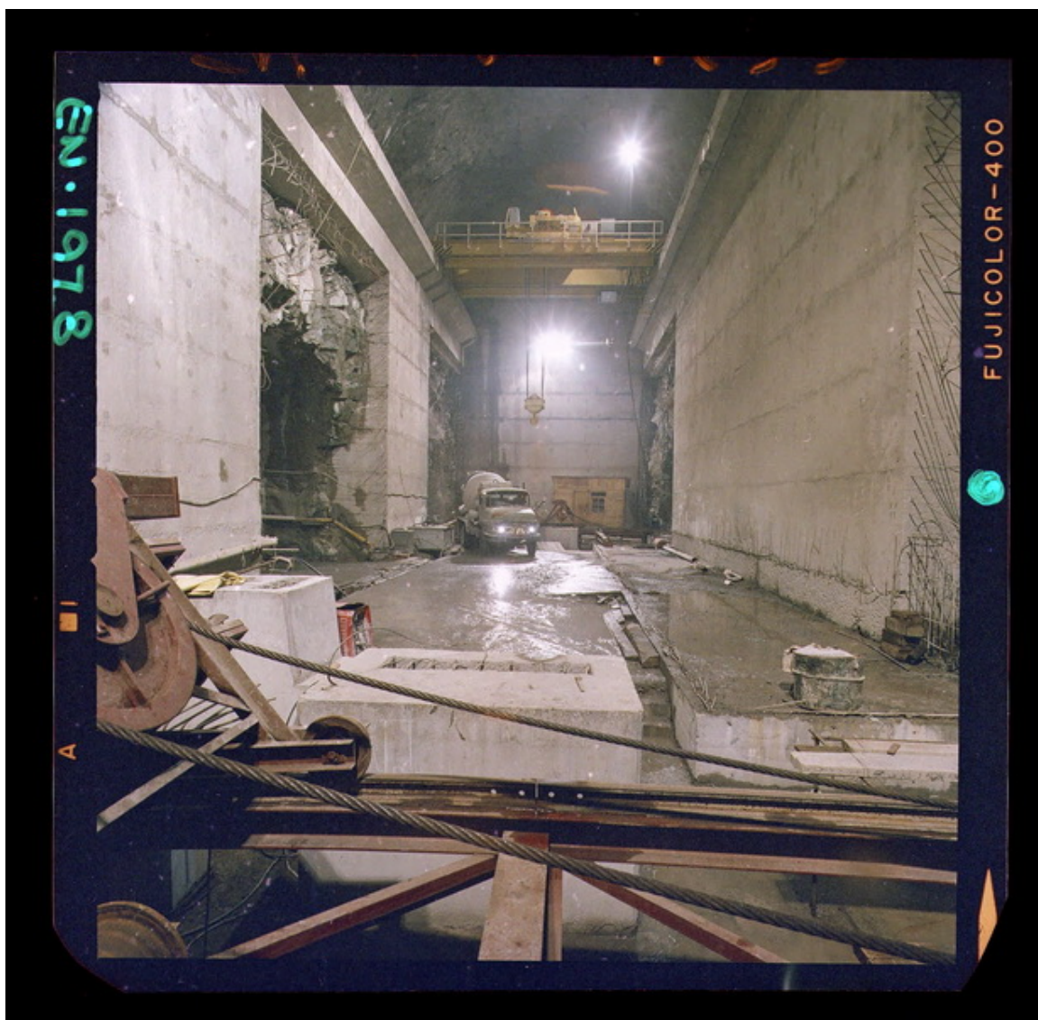
Caverna de válvulas [fotografía] Luis Ladrón de Guevara.
