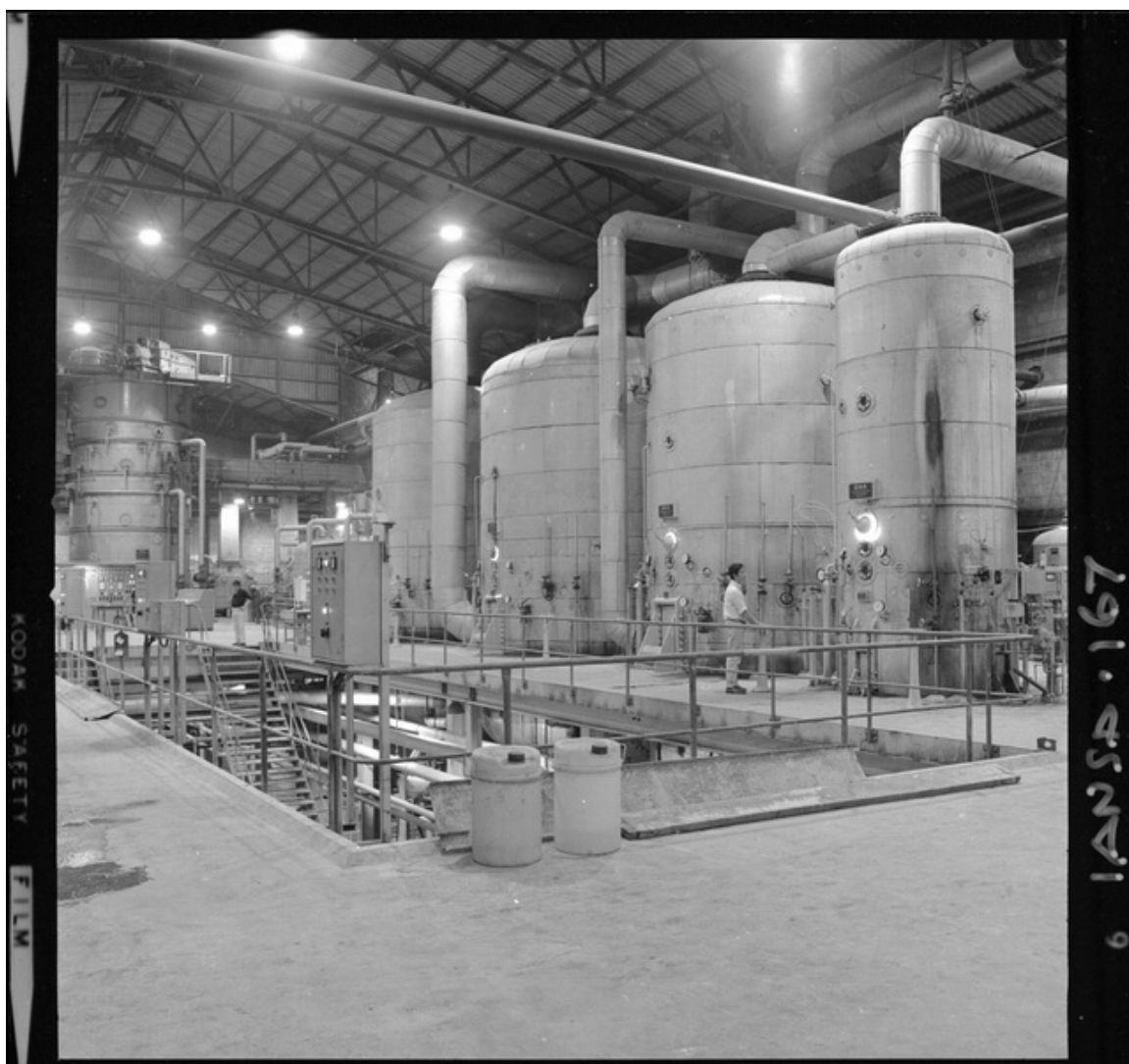
[Iansa (Chile) : Planta Linares; equipo de proceso de la firma alemana BMA] [fotografía] Luis Ladrón de Guevara.
