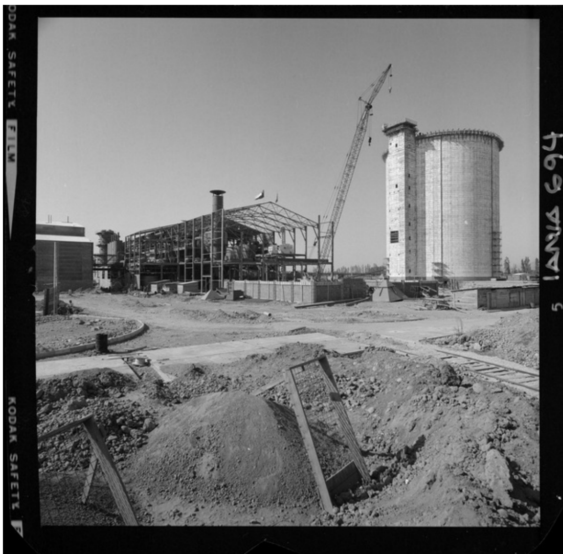
Iansa (Chile) : [Planta Curicó: Silo, obra en construcción] [fotografía] Luis Ladrón de Guevara.
