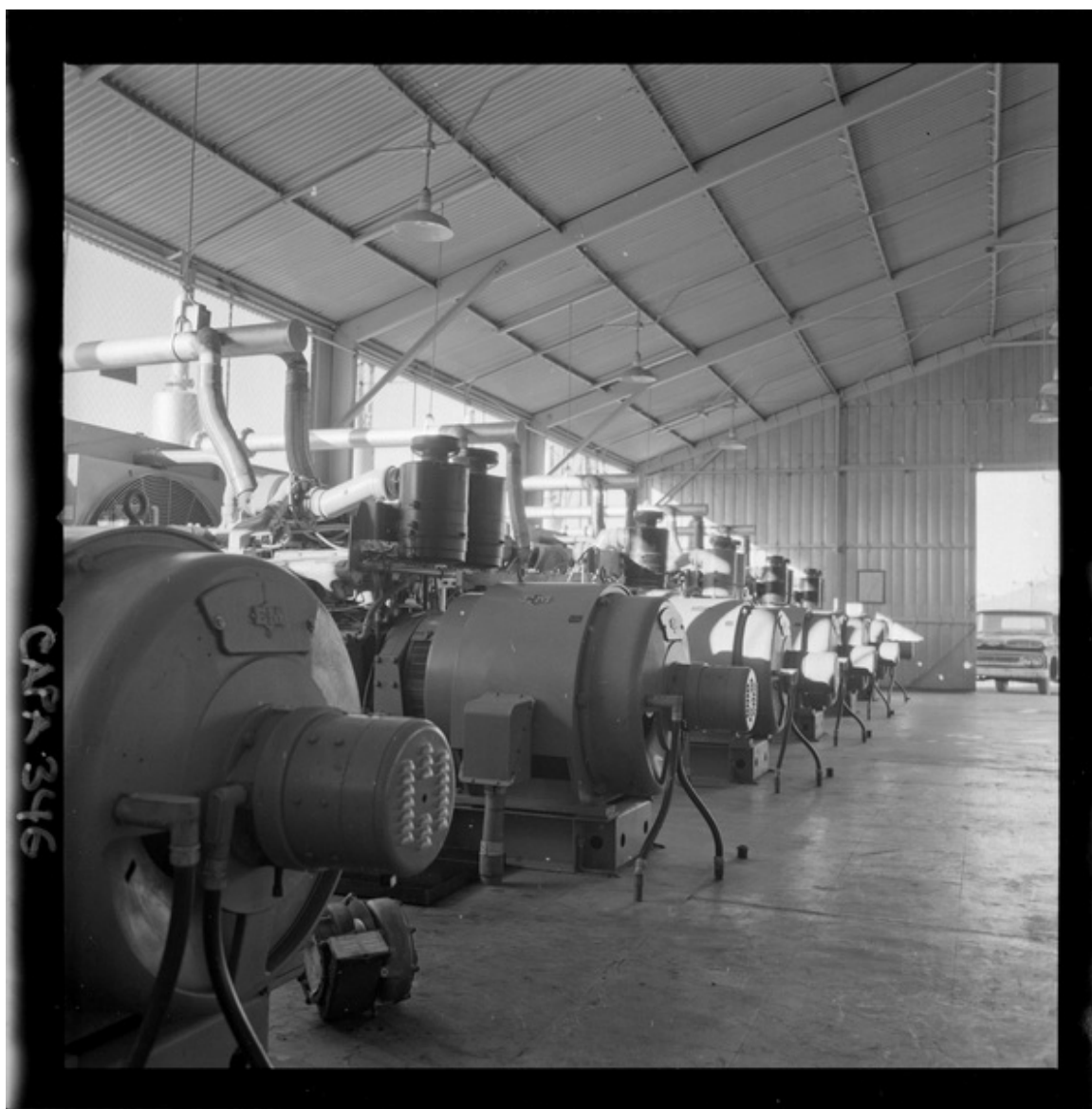
[Instalaciones interiores, mineral de hierro "El Algarrobo"] [fotografía] Luis Ladrón de Guevara.
