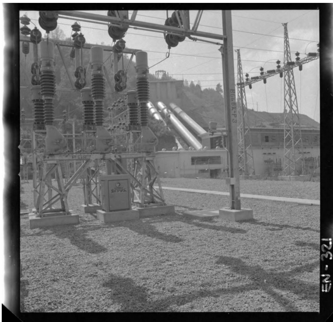
[Patio de alta tensión y torres de conducción, junto al edificio de la Central "Pullinque"] [fotografía] Luis Ladrón de Guevara.
