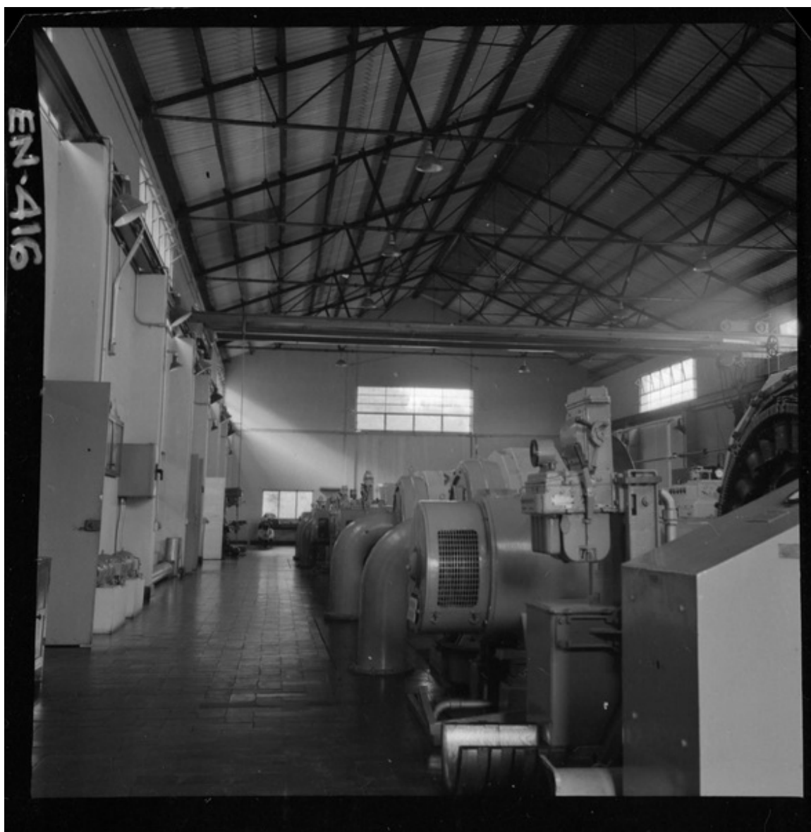
[Central Diesel Eléctrica Guayacán] [fotografía] Ladrón de Guevara, Luis,
