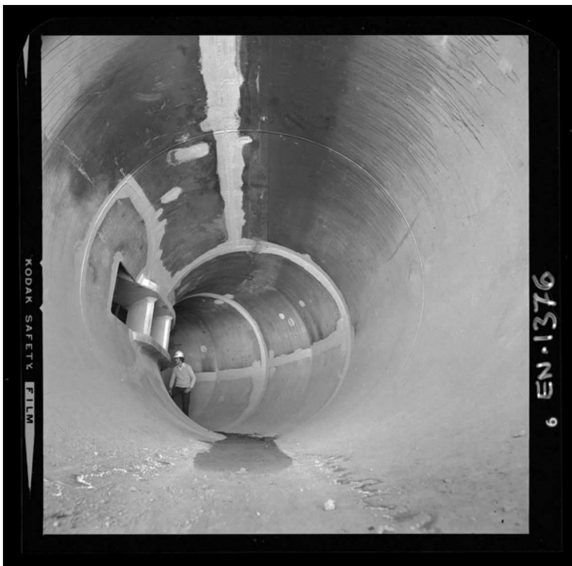
[Casa de máquinas en una segunda etapa : vista interior, aspecto del montaje del caracol de la turbina] [fotografía] Luis Ladrón de Guevara.
