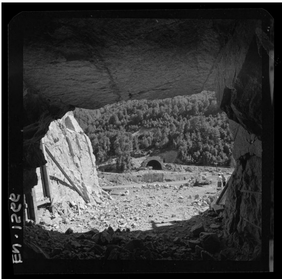
Llegada del túnel de aducción al río Pichipolcura y cepa de apoyo de tubería de acero para el cruce sobre el río [fotografía] Luis Ladrón de Guevara.
