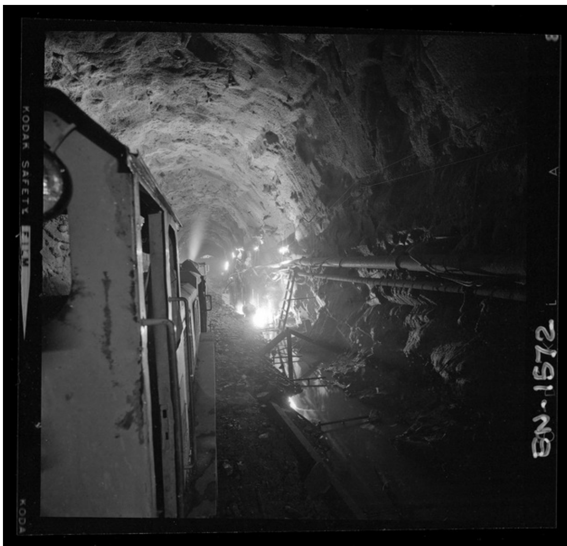
Aspecto de túneles en etapa de terminación, uso de moldajes retráctiles y hormigonado de bóveda [fotografía] Luis Ladrón de Guevara.
