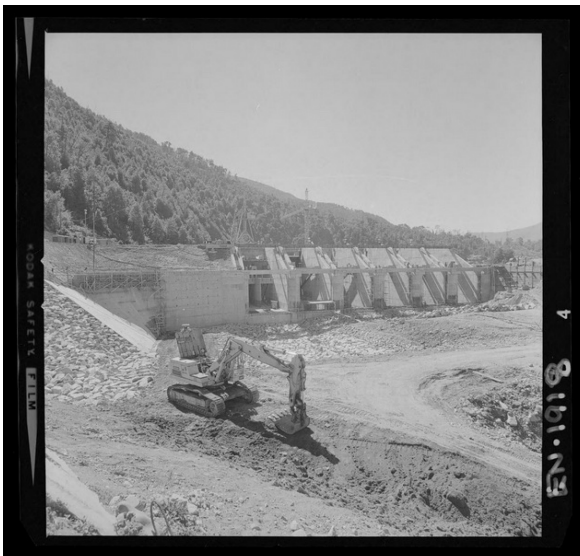
[Río Polcura; vista de las obras de construcción de la bocatoma Polcura, última etapa] [fotografía] Luis Ladrón de Guevara.
