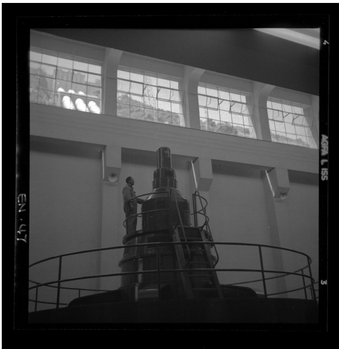
[Vista interior, uno de los generadores de la Central Hidroeléctrica "Sauzal"] [fotografía] Luis Ladrón de Guevara.
