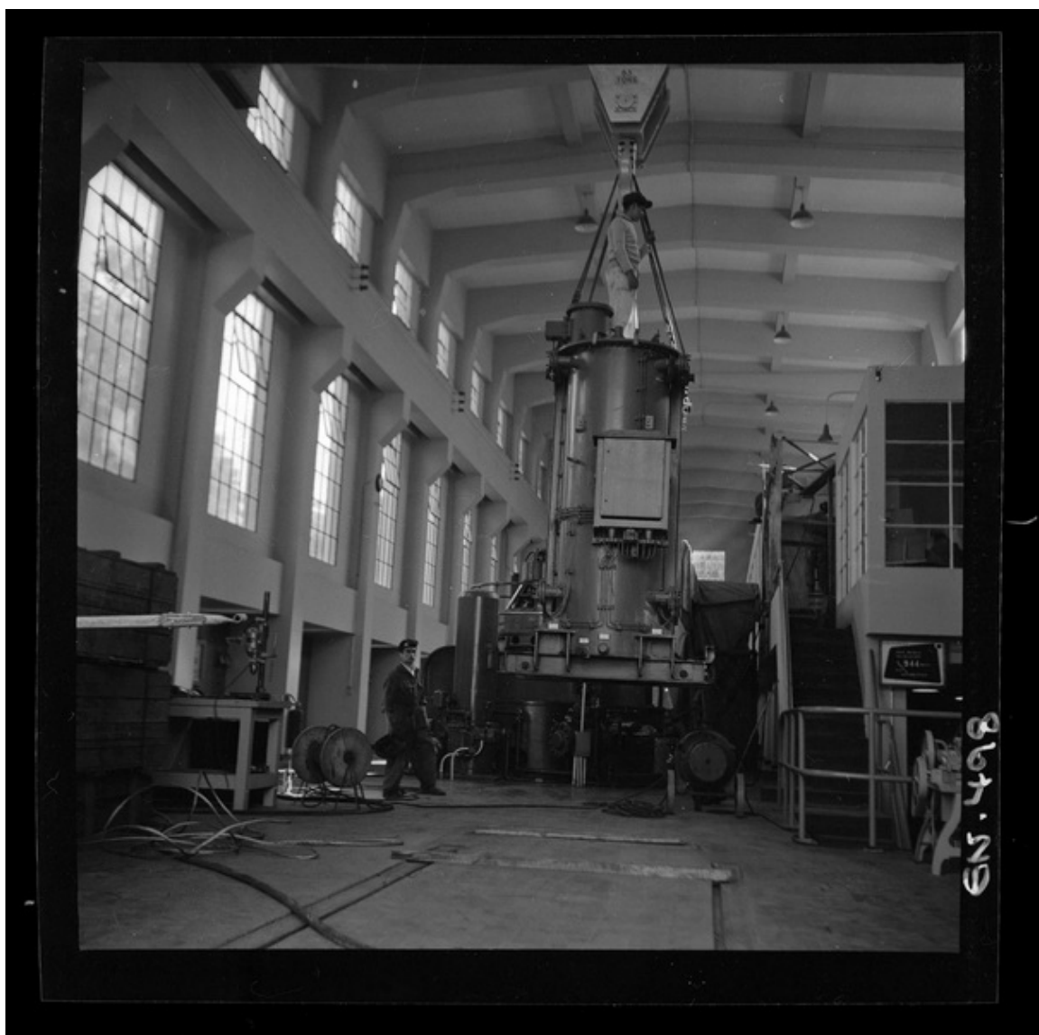
Interior de la casa de máquinas, se aprecian algunos de sus cinco generadores [fotografía] Luis Ladrón de Guevara.
