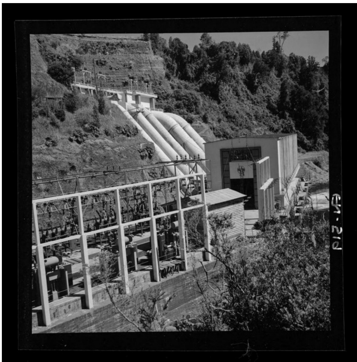
Transformadores en el patio de Alta Tensión, donde la energía generada de 6.900 voltios es elevada a 66.000 voltios [fotografía] Luis Ladrón de Guevara.
