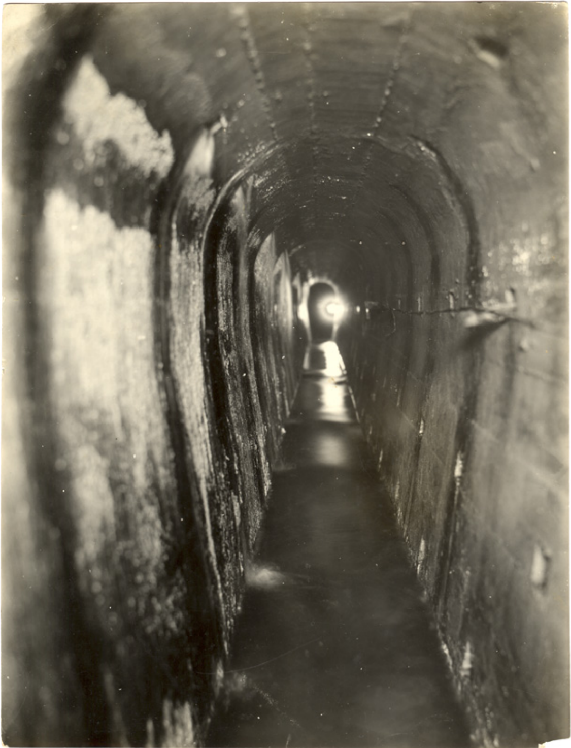
Galería filtrante en punta de piedra
