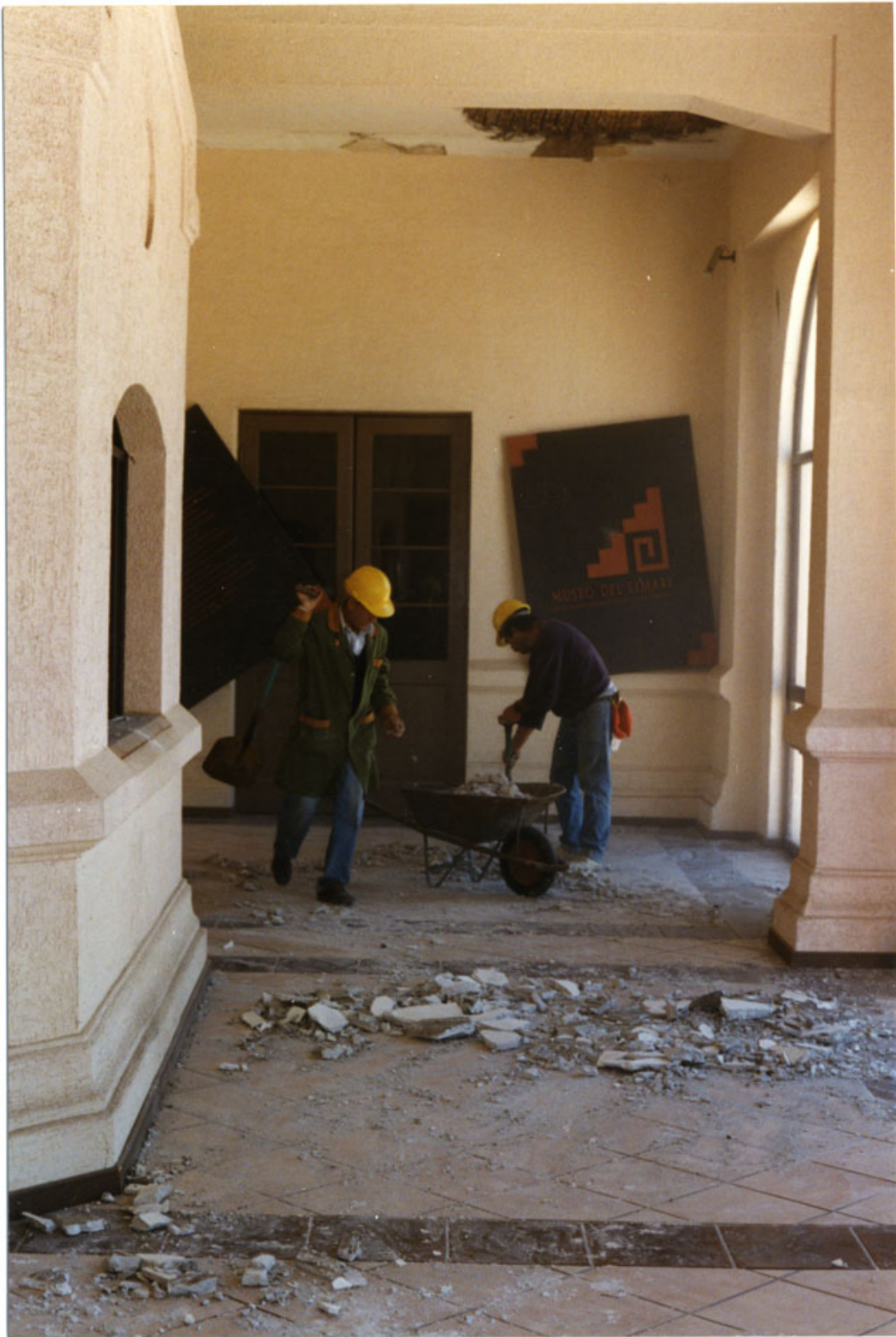
Terremoto en Ovalle
