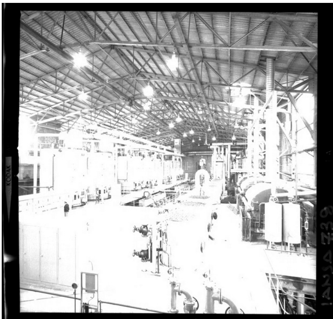
[Iansa (Chile) : Planta Curicó : Instalaciones interiores] [fotografía] Luis Ladrón de Guevara.
