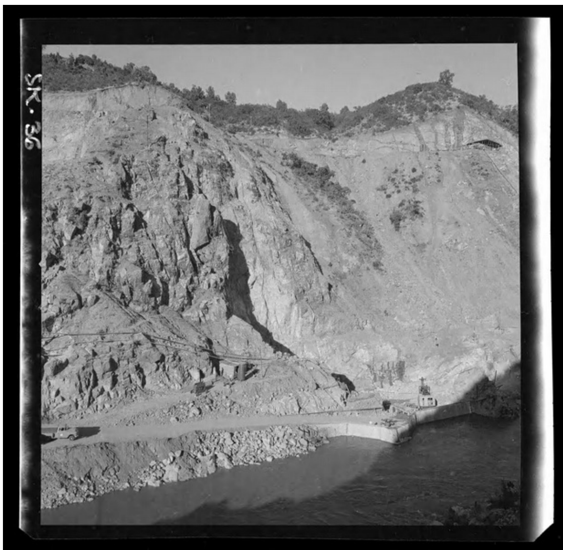
[Construcción de la entrada del túnel común de aducción] [fotografía] Luis Ladrón de Guevara.
