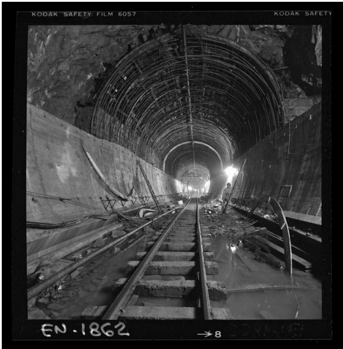
Aspecto de túneles en etapa de terminación, uso de moldajes retráctiles y hormigonado de bóveda [fotografía] Luis Ladrón de Guevara.
