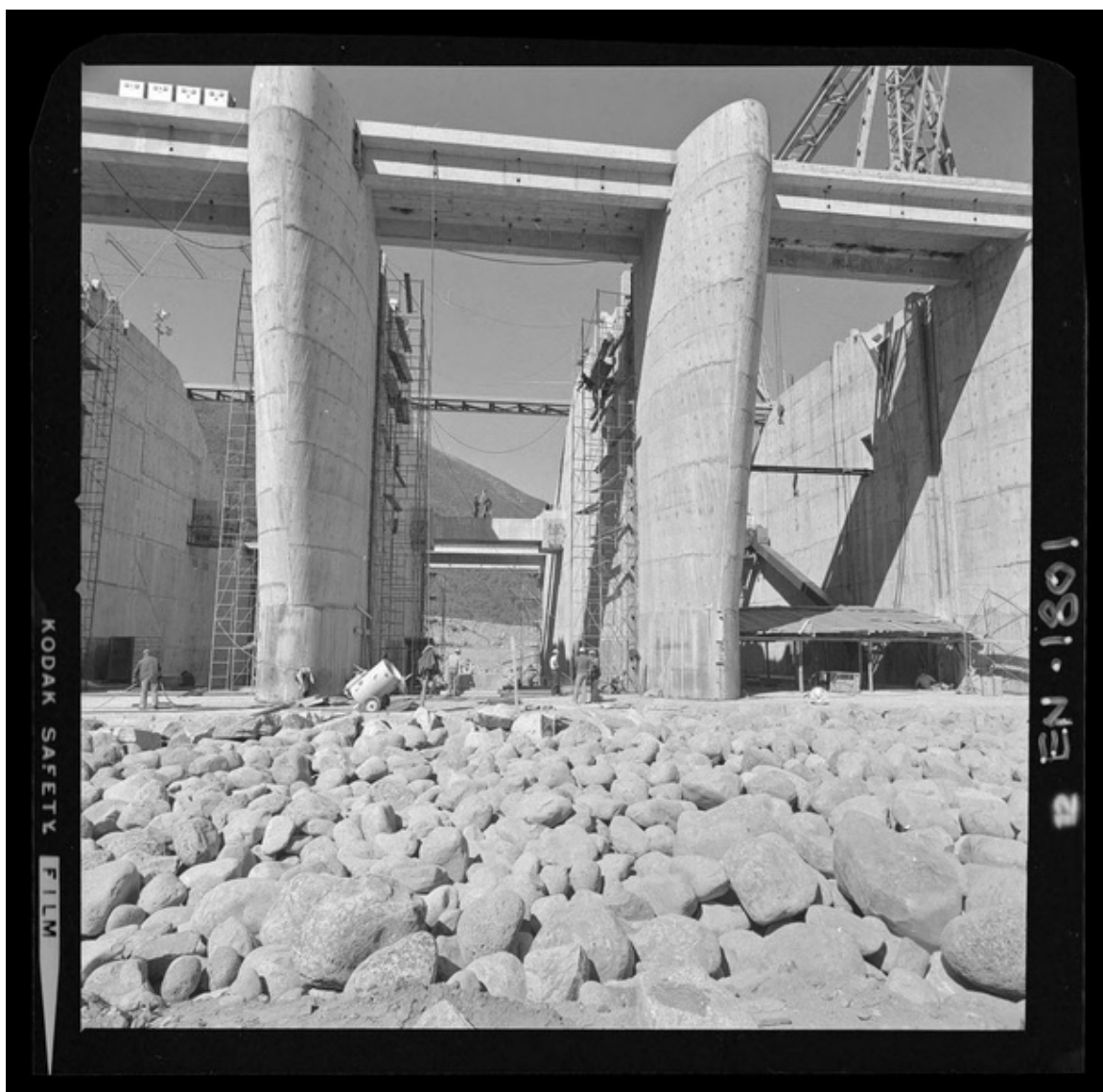
[Río Polcura; obras de construcción de la bocatoma Polcura, última etapa] [fotografía] Luis Ladrón de Guevara.
