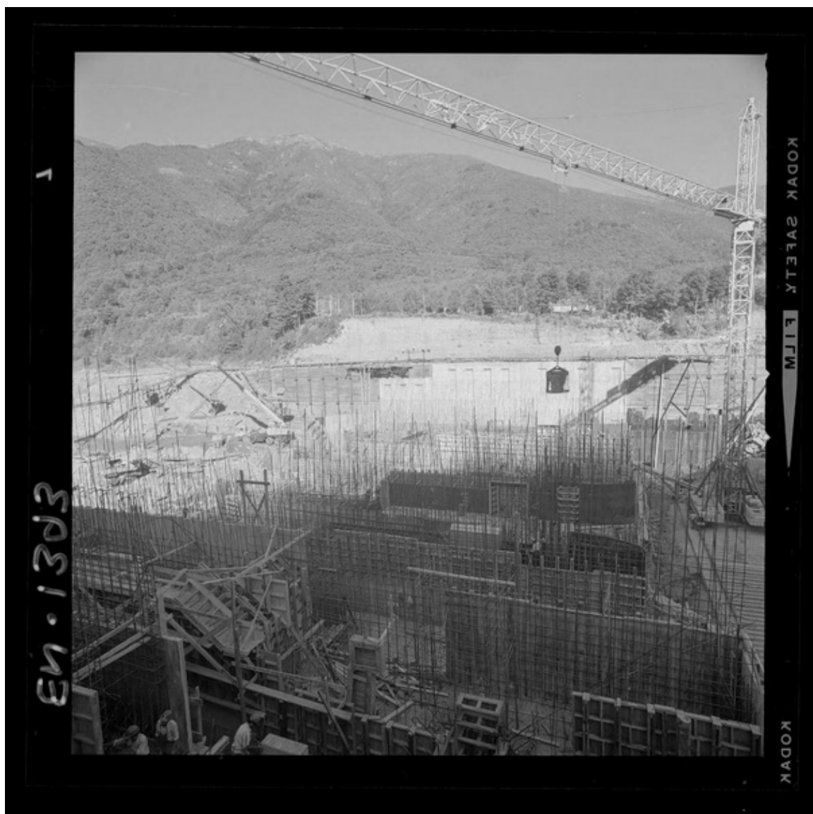
[Río Polcura; vista de las obras de construcción de la bocatoma Polcura] [fotografía] Luis Ladrón de Guevara.
