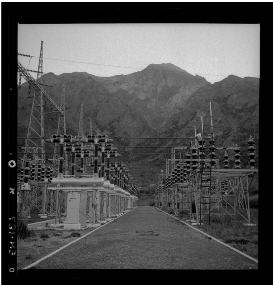
Patio de alta tensión y torres de conducción [fotografía] Luis Ladrón de Guevara.
