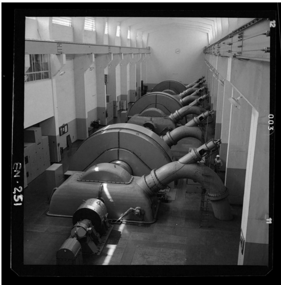
[Tres unidades generadoras, interior de la casa de máquinas] [fotografía] Luis Ladrón de Guevara.
