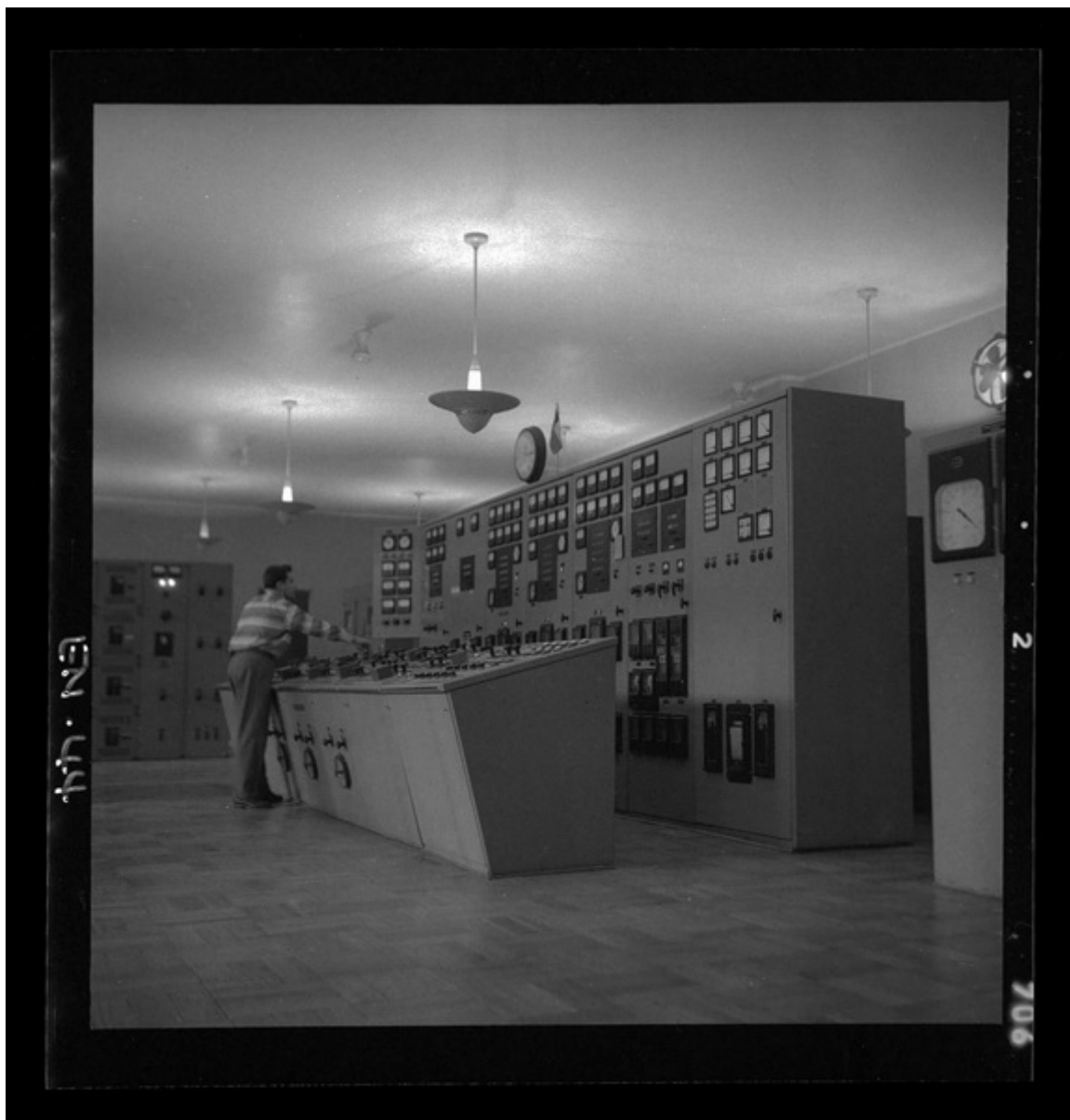
[Sala de Comando, Central Hidroeléctrica "Sauzalito"] [fotografía] Luis Ladrón de Guevara.
